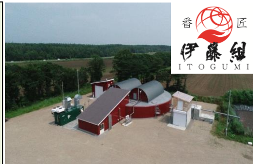
(完成したバイオマス発電所)
